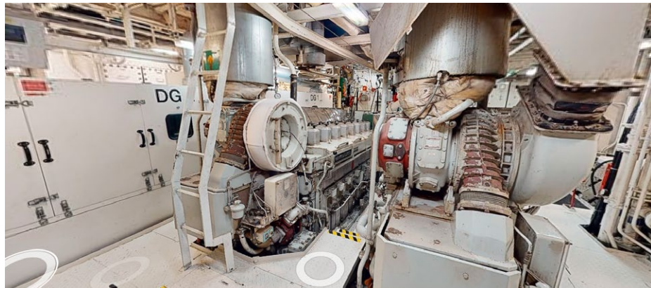
Kuva 2. Merikarhu koululaivan konehuone ja liikumisen mahdollistavat tunnisteet digitaalisessa oppimisympäristössä kuvattuna.
